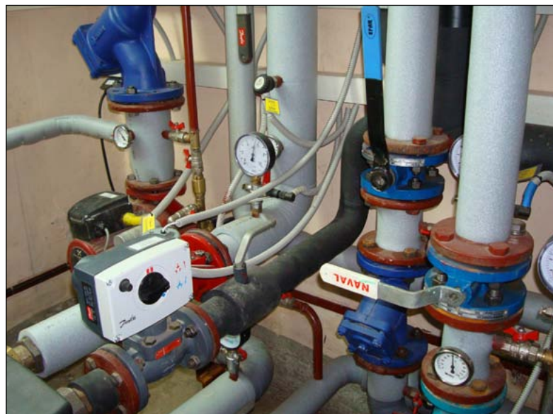
Индивидуальный тепловой пункт.
