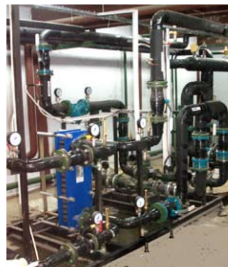
Индивидуальный тепловой пункт
