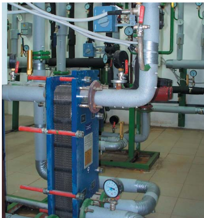
Автоматизированный индивидуальный тепловой пункт, оснащенный дистанционным контролем и управлением
